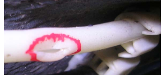
Kunststoffrohre können verspröden
